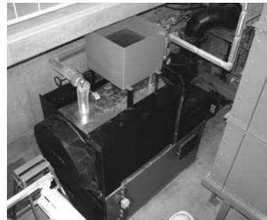
シレラ富良野の木質チップボイラー
