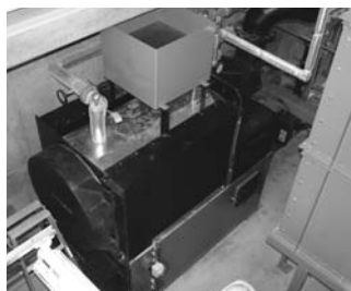
木質チップボイラー
