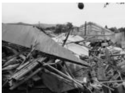
屋根が飛ばされ倒壊した農業用倉庫 (金山高台)
