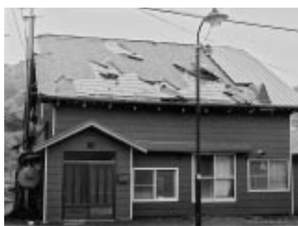
屋根のトタンが飛ばされた住宅(金山市街)
